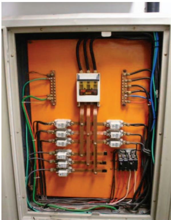
Figura 9. Quadro de distribuição com a interconexão do sistema fotovoltaico.
