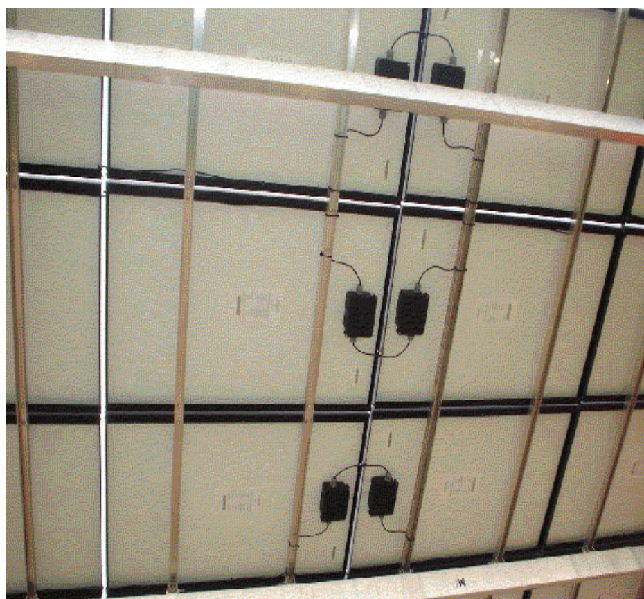
Figura 16. Detalhe da ligação elétrica entre os módulos.
