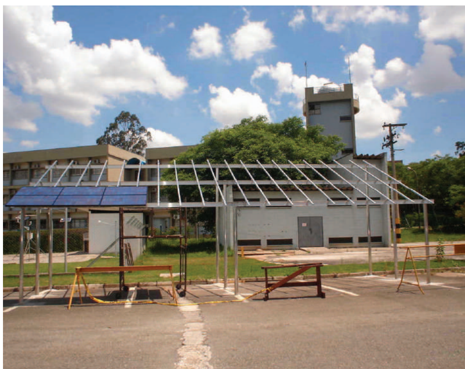
Figura 12. Estrutura de suporte.
